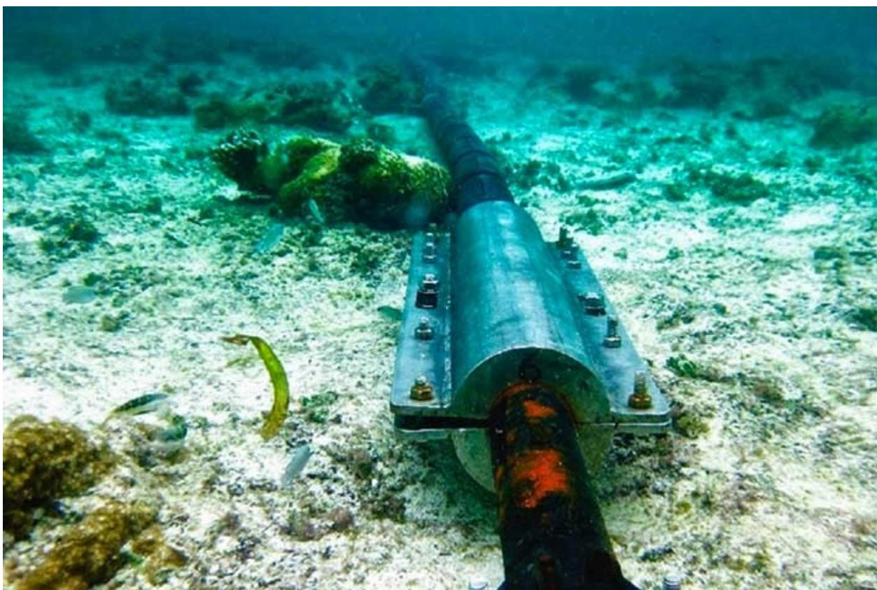
Рис. 34-3. Подводный кабель на дне. «Штука» с болтами — грузило, чтоб не всплыл или не сдвинуло течением
